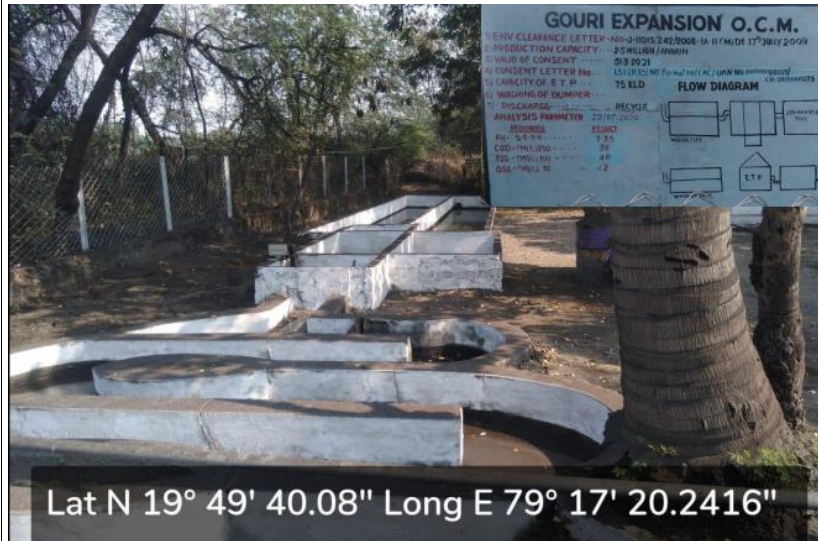
एफ्लुएंट ट्रीटमेंट प्लांट
