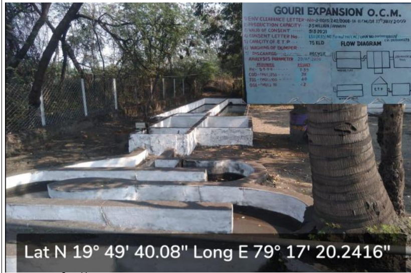
एफ्लुएंट ट्रीटमेंट प्लांट
